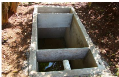
Figura 9 – Exemplo de uma caixa séptica construída
