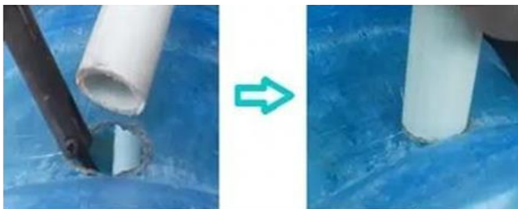
Figura 7 – Abertura lateral no galão
