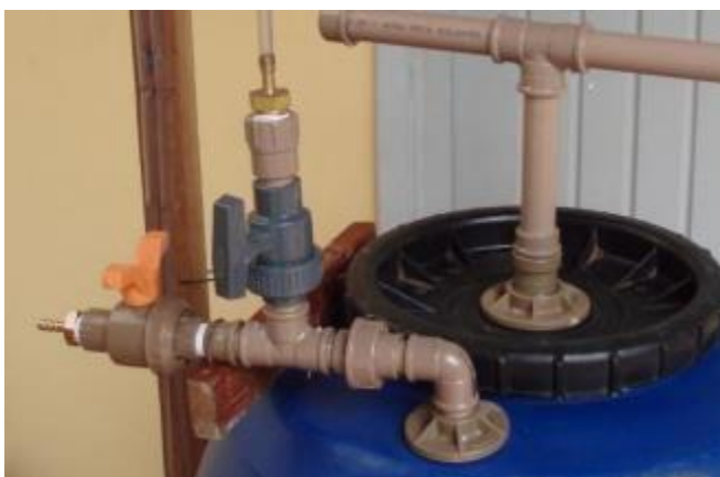
Figura 30 – Dreno da saída de gás
