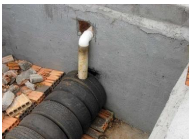
Figura 5 – Dutos de inspeção
